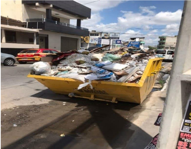
Fonte: Autora. Figura 2 – Resíduo de demolição descartado de forma irregular no sinal entre a Avenida Rio Branco e a Avenida Agamenon Magalhães
