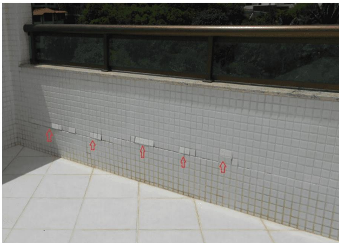
Figura 03 – Descolamento de pastilhas no muro.
